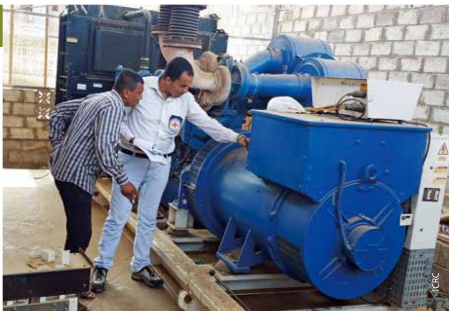
発電機のモーターを確認するICRCのエンジニア
